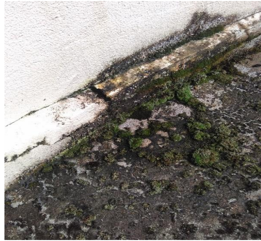
Foto 19 – Detalhe da formação de fungos na estrutura
