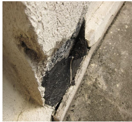
Foto 23 – Descolamento da manta impermeabilizante do pilar
