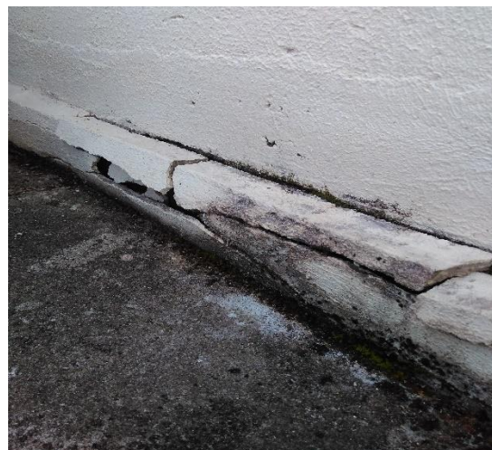
Foto 21 – Estufamento e formação de trincas nos rebocos das vigas
